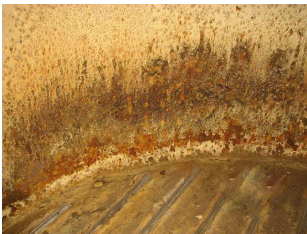
Рис.1. Коррозия внутренней стенки резервуара
