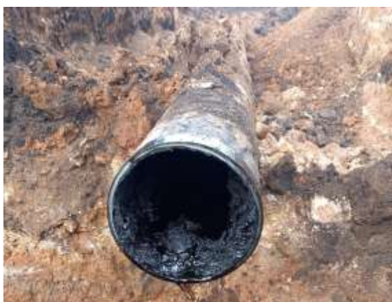
Рис. 1. Текущее состояние напорного трубопровода «УПСВ Капровская - УПН Красноярская»
