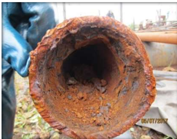
Рис.2. Типичное состояние стальных высоконапорных трубопроводов системы ППД
