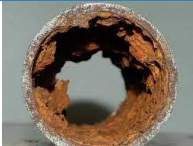
Рис. 4 Коррозия металла подземного оборудования
